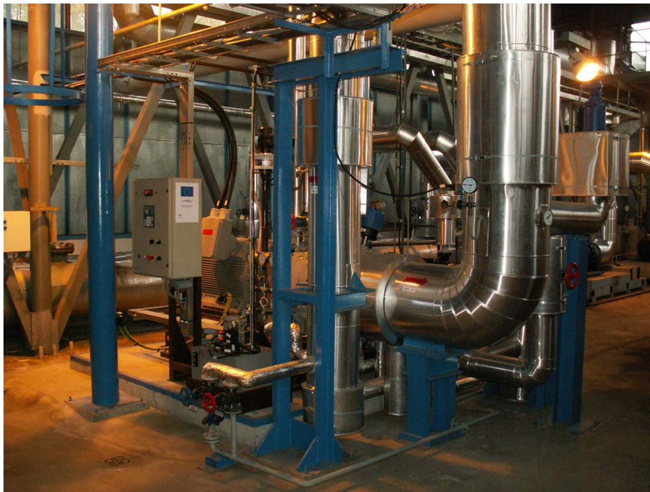
TOČIVÁ REDUKCE TR 320 – ENERGIE Holding a.s.- Ralsko - Výtopna Hradčany
