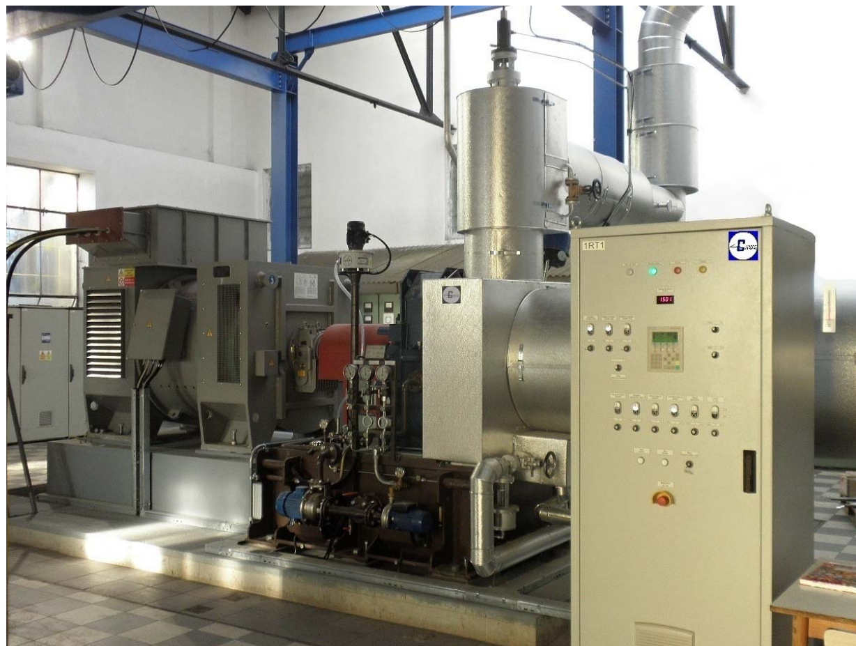
TOČIVÁ REDUKCE TR 560 – Litovelská cukrovarna,a.s. - Litovel Steam turbine TR 560 – Litovelská cukrovarna,a.s. - Litovel
